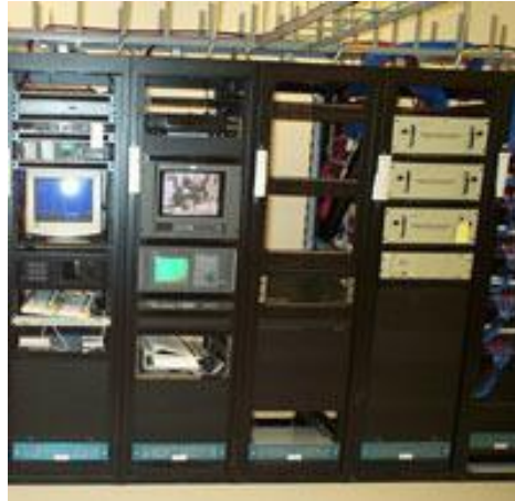
Figura 5 Panel frontal de una cabecera de CATV
